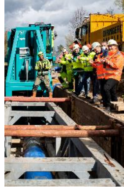
Freude bei den beteiligten Partnern von D&S, IRS und RAKW über das Eintreffen des neuen PE-Rohrstranges in der Zielgrube
